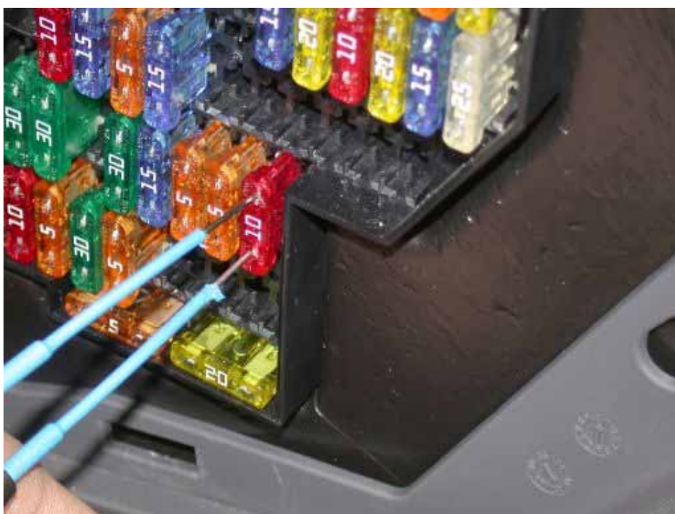
Afbeelding 1: Stroommeting over zekeringen
